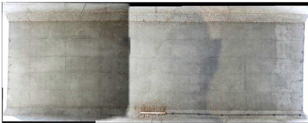
図9 床版部分の大域統合画像
