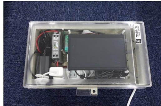
図3 データ収集システムの外観
